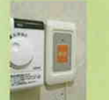
呼出しボタン
